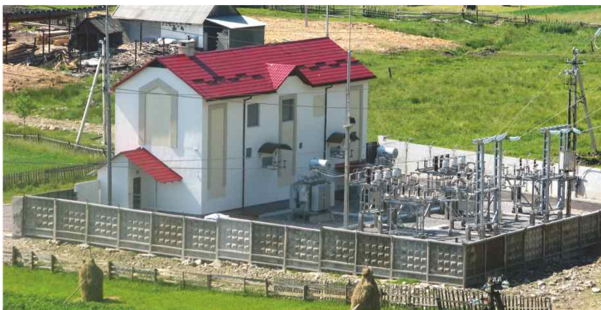
Podstacja 35 kV "Porohy". Uruchomiona w grudniu 2011 roku. Budowa trwała ponad sześć miesięcy.
