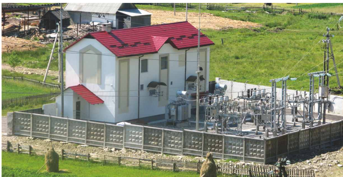
Підстанція 35 кВ «Пороги». Здана в експлуатацію в грудні 2011 року. Будівництво тривало понад шість місяців.
